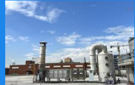
会社管理 VOCs廃棄処理
